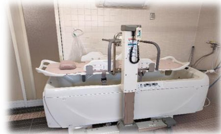
● 浴室（機械浴槽）
